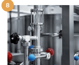
Lauter run off control with micrometric valve and inspection sight-glass. Régulation de filtration avec vanne micrométrique et verre regard.
